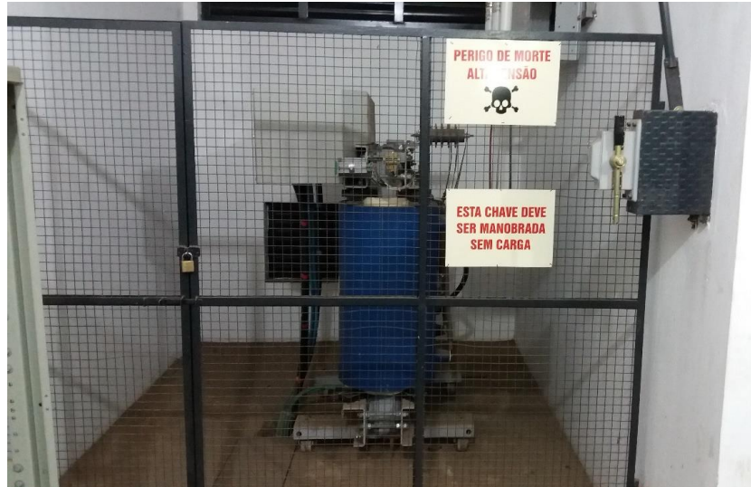
Figura 4.6 – Transformador 2, 225 kVA, 13,8/0,38 kV.
