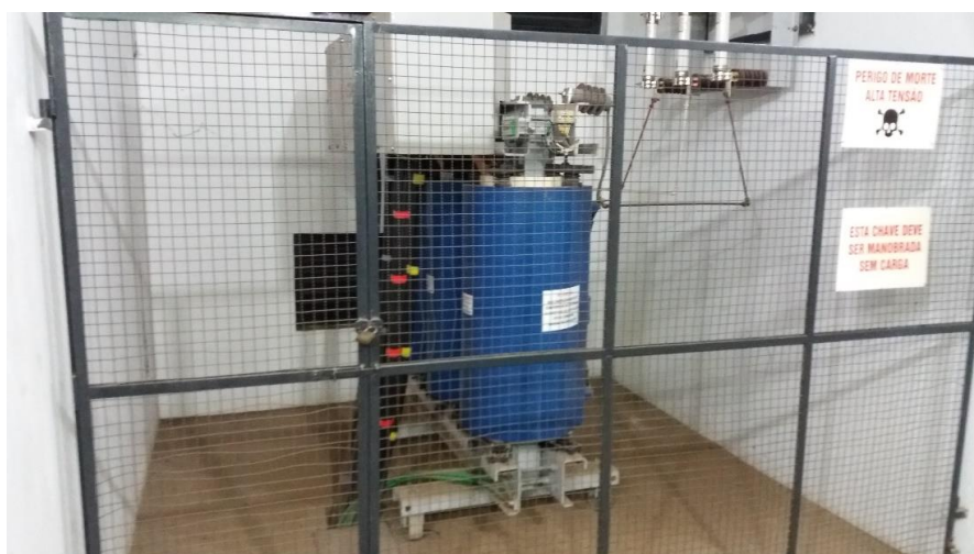
Figura 4.4 – Transformador 1, 500 kVA, 13,8/0,38 kV.
