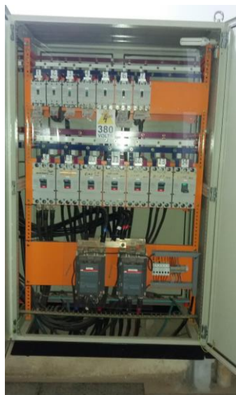
Figura 4.5 – QGF-1: Quadro Geral de Força 1.
