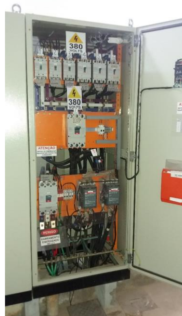
Figura 4.7 – QGF-2: Quadro Geral de Força 2.
