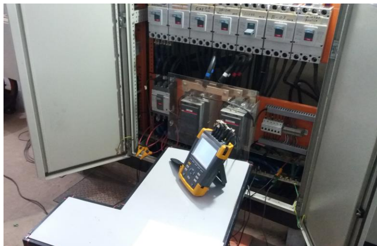
Figura 4.10 – Detalhe das medições realizadas no ponto de medição M3 no QGF-1/ Transformador 1.
