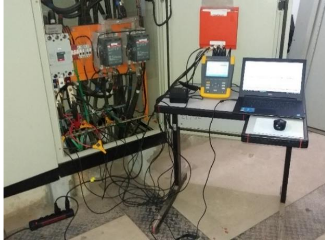
Figura 4.9 – Detalhe das medições realizadas no ponto de medição M2 no QGF-2/ Transformador 2.
