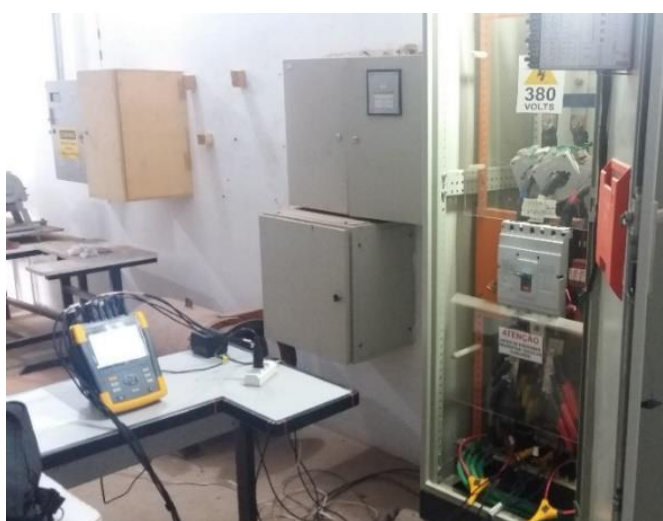
Figura 4.8 – Detalhe das medições realizadas no ponto de medição M1 no QGF-1/ Transformador 1.
